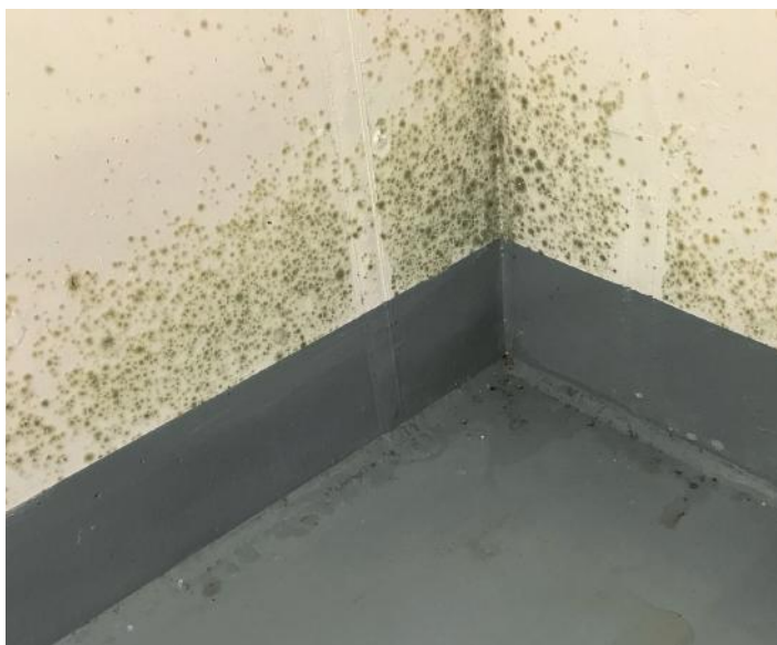
Schimmelsporen an einer Kellerwand zur Tiefgarage
