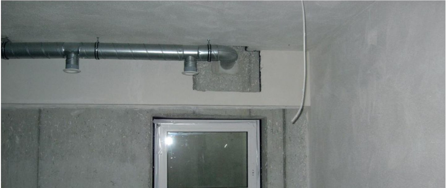
Lüftungsflügel für einen unbeheizten Kellerraum
